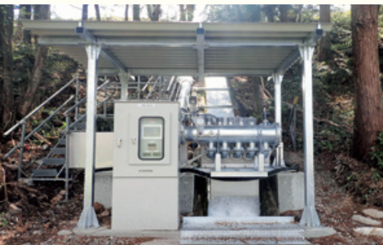
鳥越小水力発電所の水車と流量調整盤
